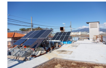
屋上には太陽光パネル
